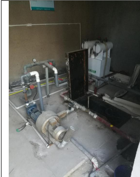
图 4-3 污水处理站内部
