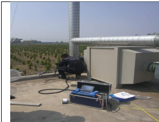
图 4-1 污水处理站废气处理设施
