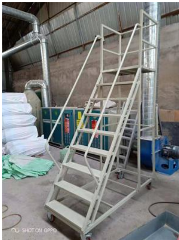
图 4-1 废气处理设施
