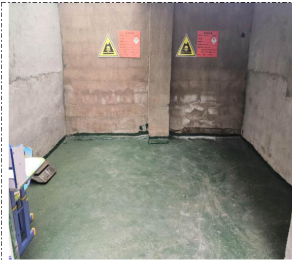
图 1 危废库地面防渗及标识
