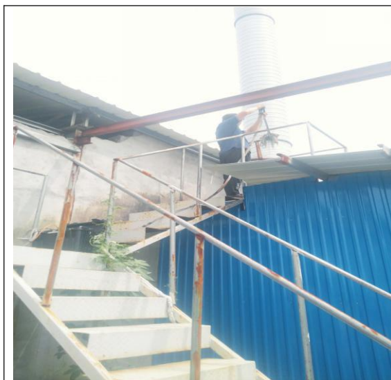
图 4-5 本项目废气排放口
