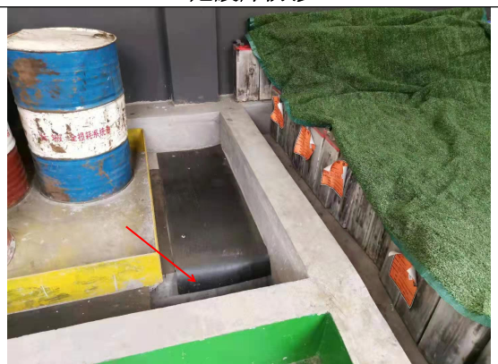
危废库收集池
