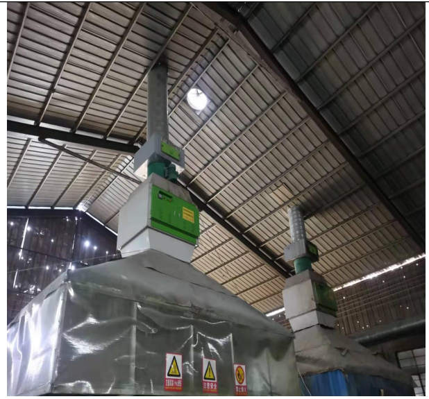
热压涂胶废气处理设施
