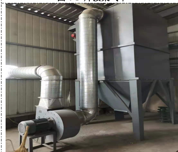
图 4-3 切割、焊接废气除尘器
