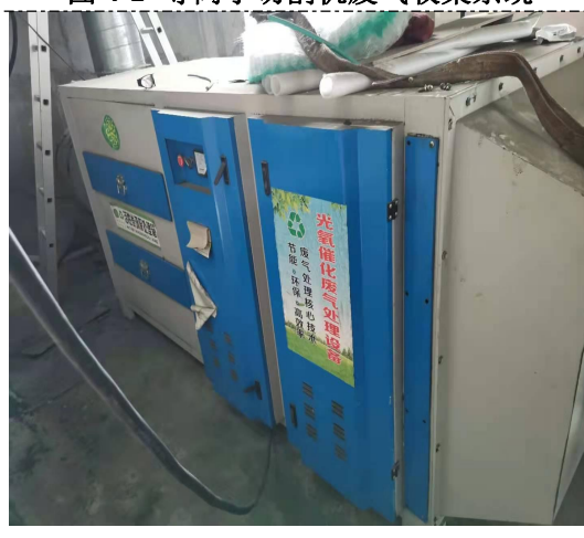
图 4-4 喷漆废气处理系统
