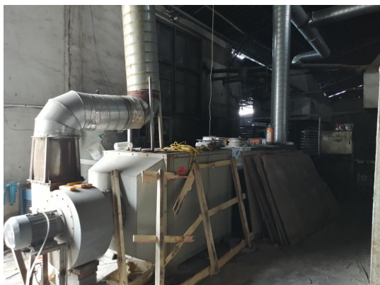
涂胶、热压工序环保设施
