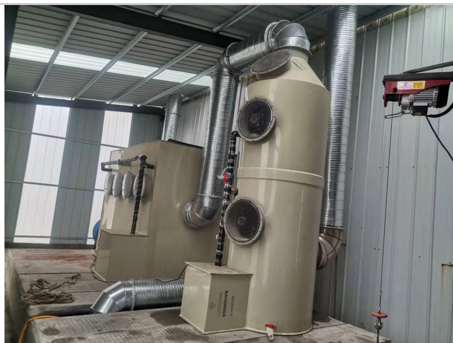
碱喷淋+生物除臭装置
