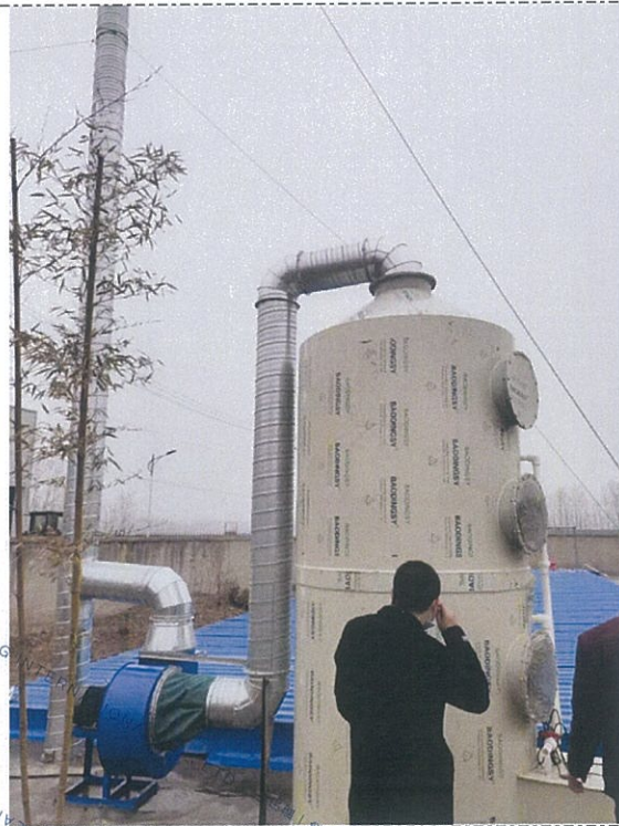
图 2: 厌氧池废气治理设施
