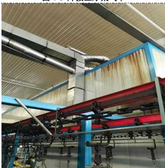
图 4-3 烘干室及废气收集管道
