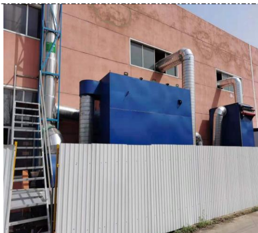
图 4-2 东侧焊接烟尘处理设施
