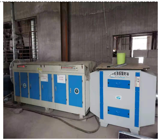
图 4-2 注塑有机废气处理设施
