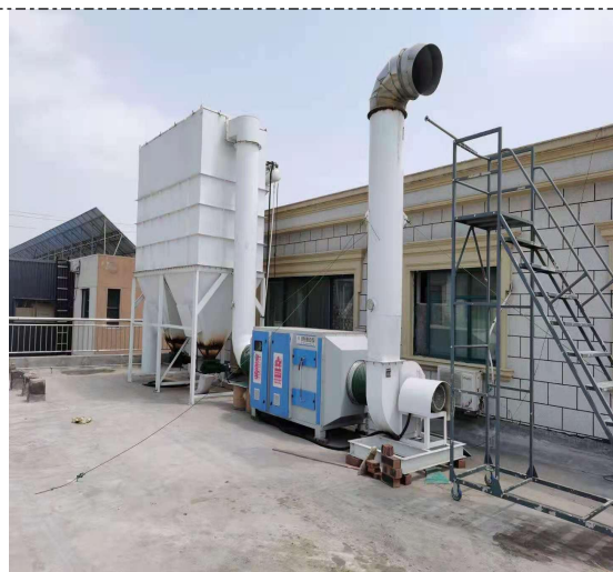
图 4-4 废气排放口及检测平台
