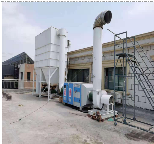
图 4-2 废气处理设备（除尘器+光氧+活性炭）
