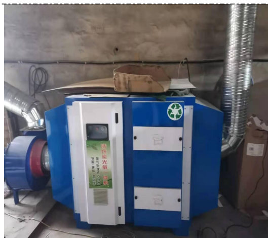
图 4-2 印刷有机废气处理设施
