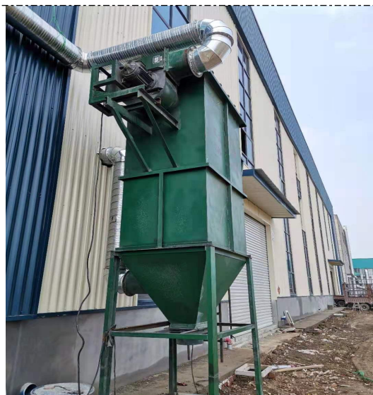
图 4-2 3#车间脉冲除尘器
