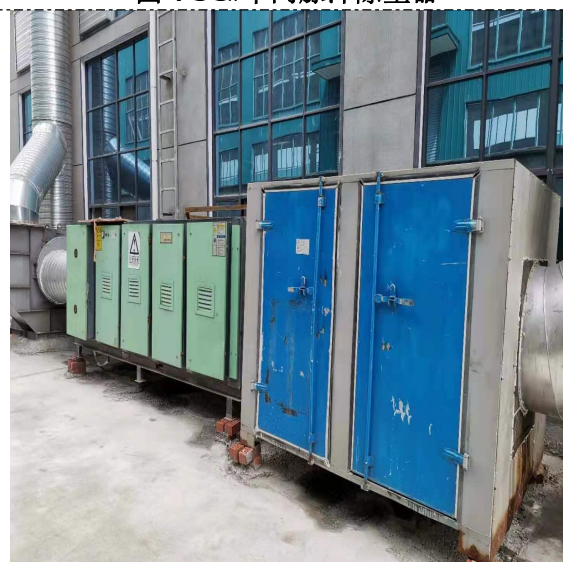
图 4-3 1#车间有机废气处理设施
