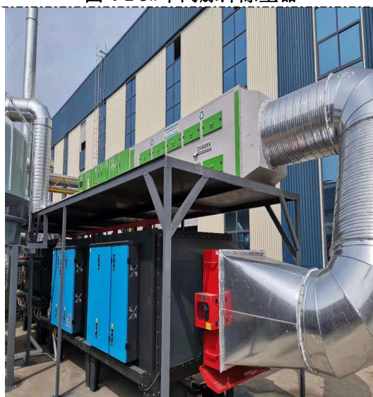
图 4-4 3#车间有机废气处理设施
