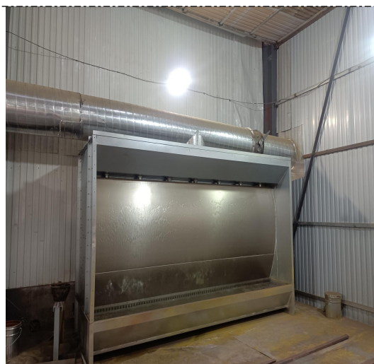
喷漆房水帘设备
