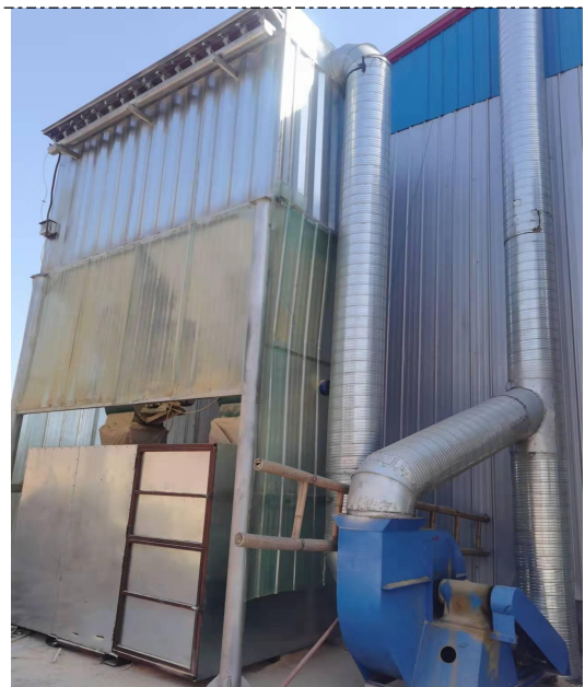
锯边+刨条废气除尘器
