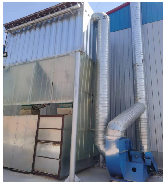
截料、梳齿废气除尘器
