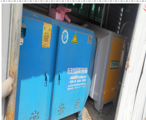
2#生产车间 PE 管挤出废气处理设施（低温等离子+活性炭）
