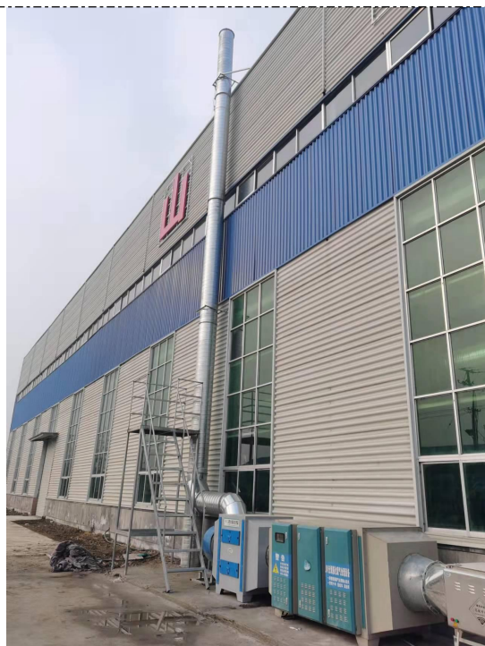
废气排放口监测平台
