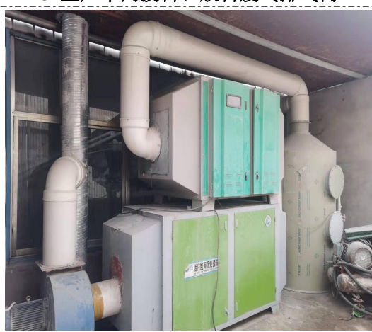
5#生产车间 PVC 管挤出废气处理设施
