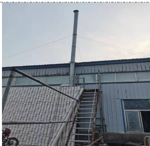
5#生产车间投料、放料废气排气筒
