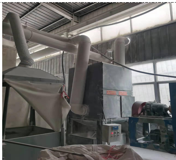
5#生产车间投料、放料集气罩及除尘器
