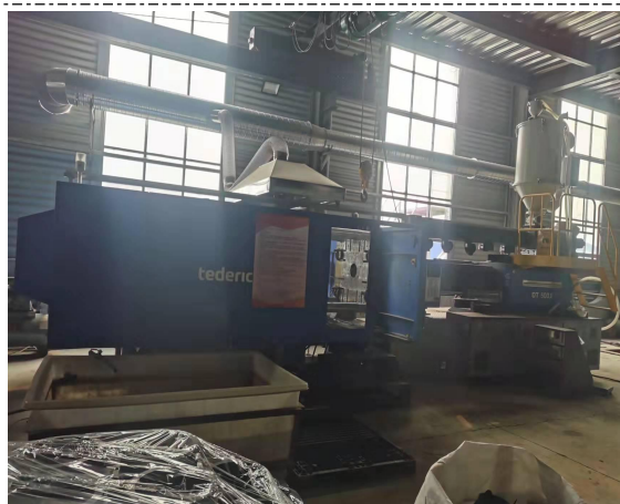
4#生产车间注塑工序废气集气罩
