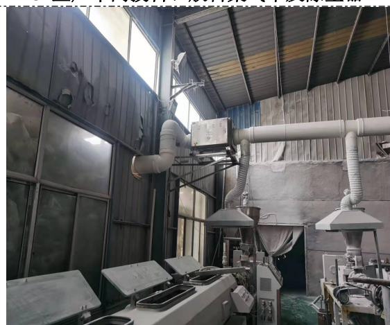
5#生产车间 PVC 管挤出废气集气罩
