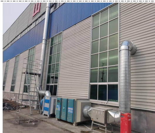
4#生产车间注塑工序废气处理设施
