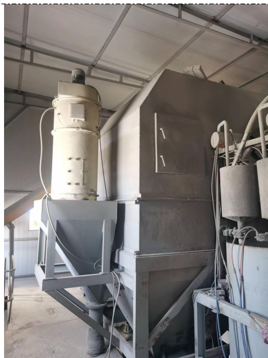
搅拌机投料除尘器
