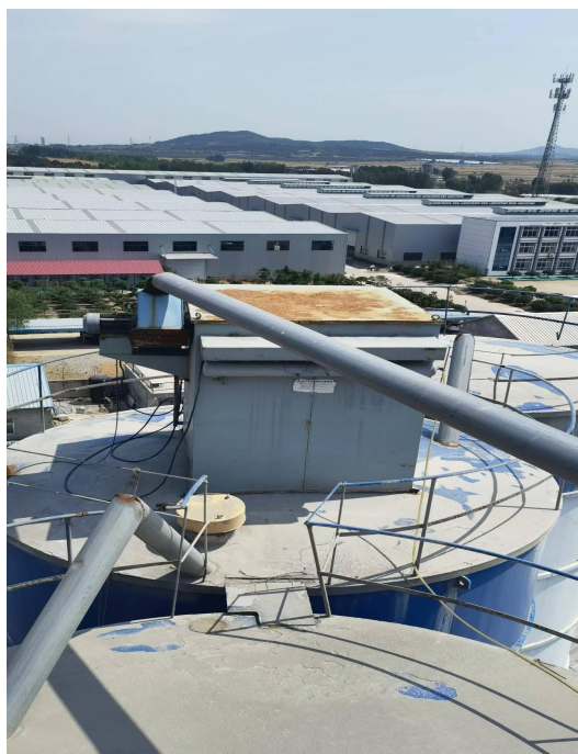
筒仓顶部除尘器
