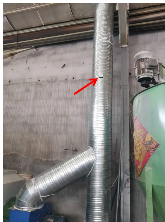
废气排放口永久采样口
