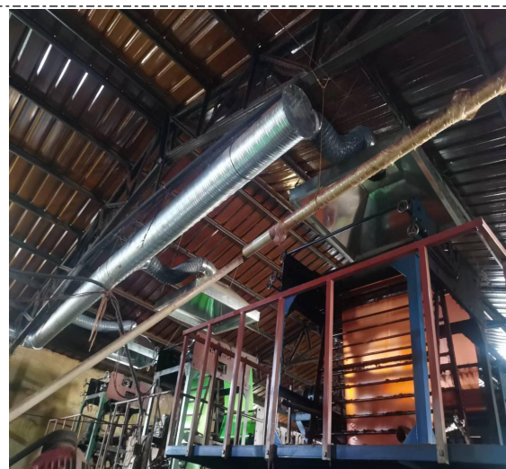
撕裂膜机废气收集系统
