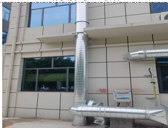
食堂油烟废气排放口
