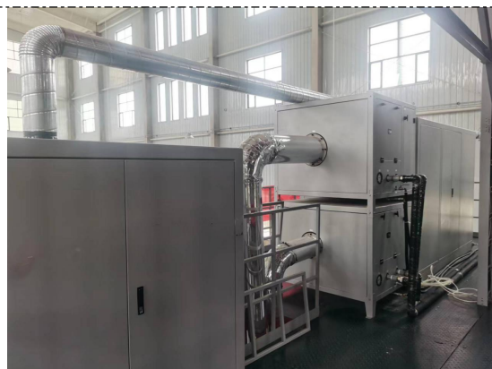
吹膜机自带废气收集装置
