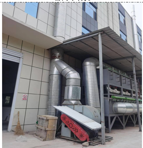
印刷废气排气筒
