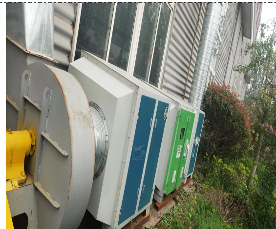
喷漆、晾干工序环保处理设备 (干式过滤箱+光氧催化+活性炭吸附)
