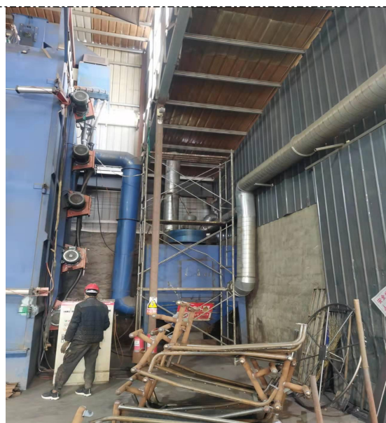
焊接烟尘、打磨粉尘、抛丸粉尘环保设施
