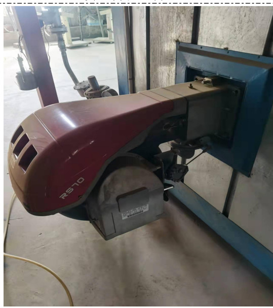
固化炉低氮燃烧器
