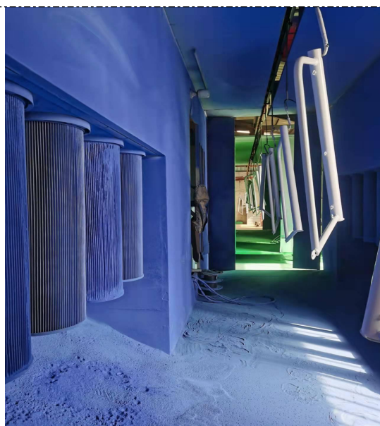
喷塑房滤芯除尘器
