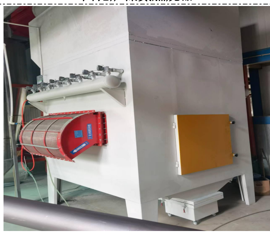
北侧喷塑房脉冲布袋除尘器
