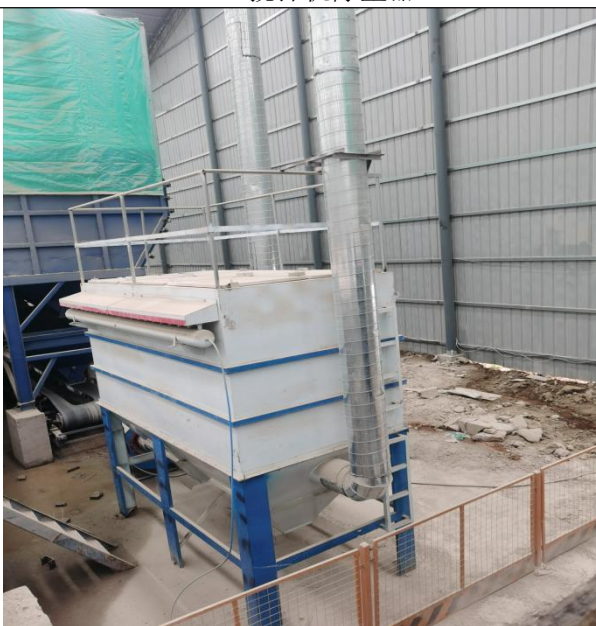
原料仓投料除尘器
