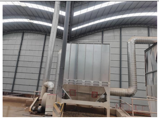
原料仓投料除尘器
