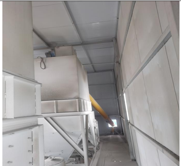
搅拌机除尘器
