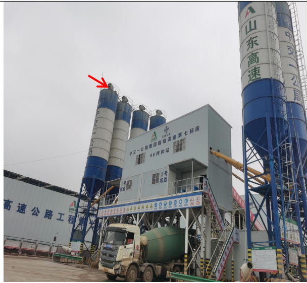
水泥筒仓顶部除尘器
