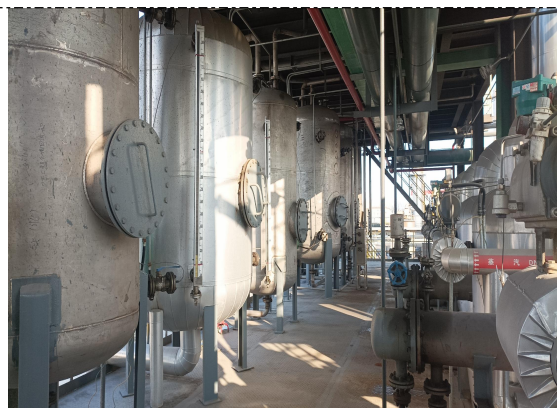
碳酸二乙酯粗分塔回流罐
