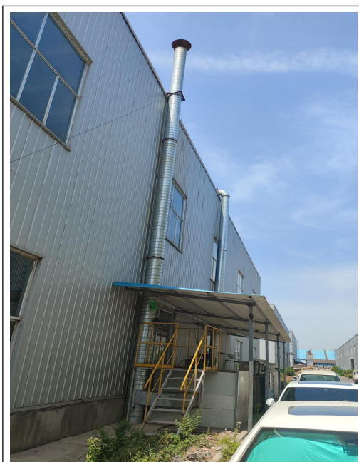
图 4-6 废气排放口采样监测平台及标识
