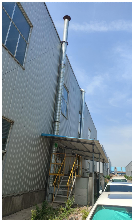
图 4-2 废气排气筒现场照片
