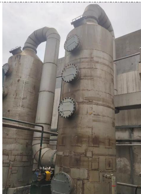
二级水喷淋塔
