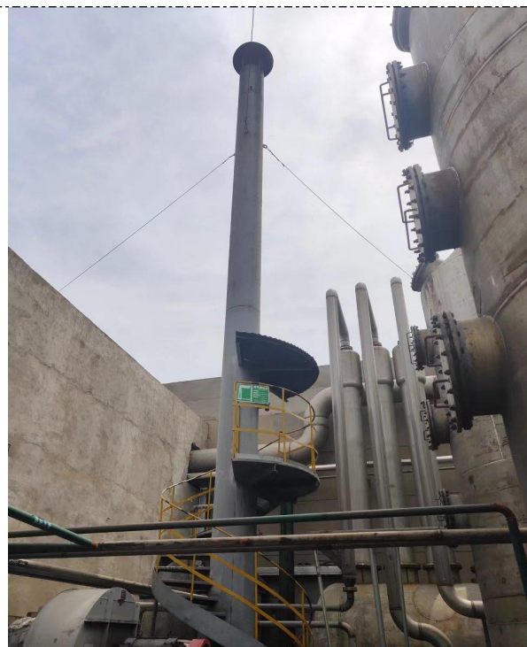
混旋苯甘氨酸生产车间废气排放口规范化建设
