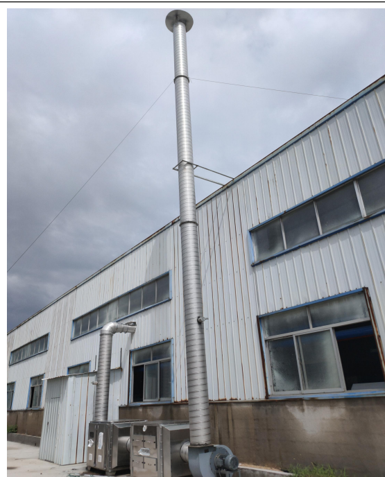
图 4-8 南注塑工序废气排放口采样监测平台及标识
