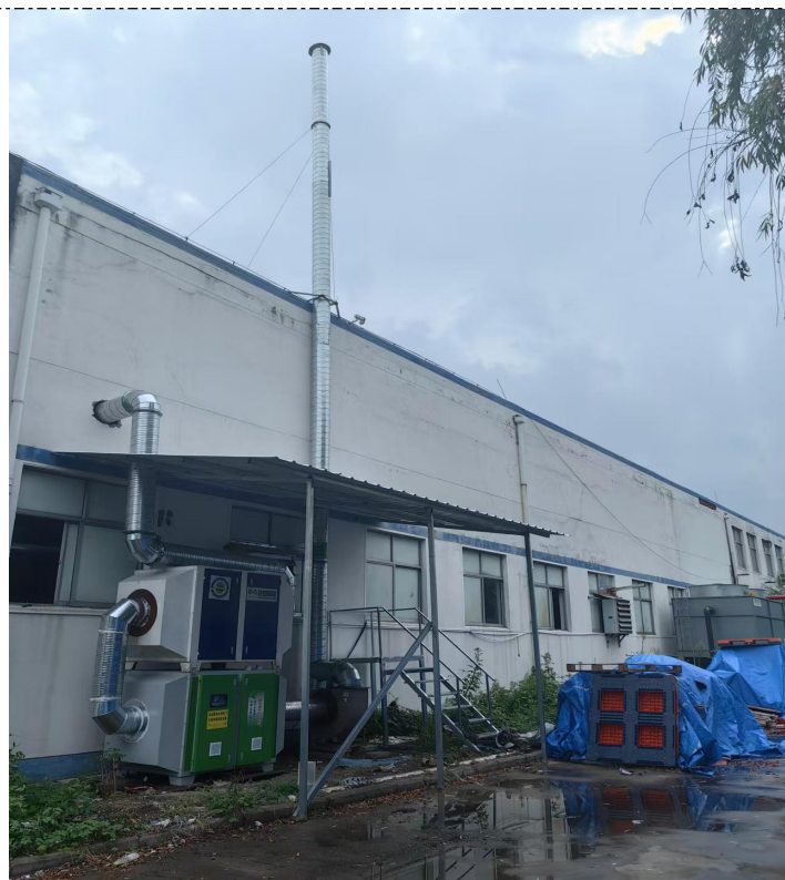
图 4-3 北注塑工序废气排气筒现场照片
