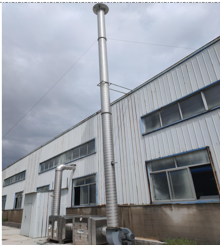
图 4-4 南注塑工序废气排气筒现场照片
