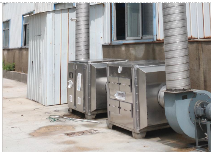
图 4-2 南注塑工序废气处理设施
