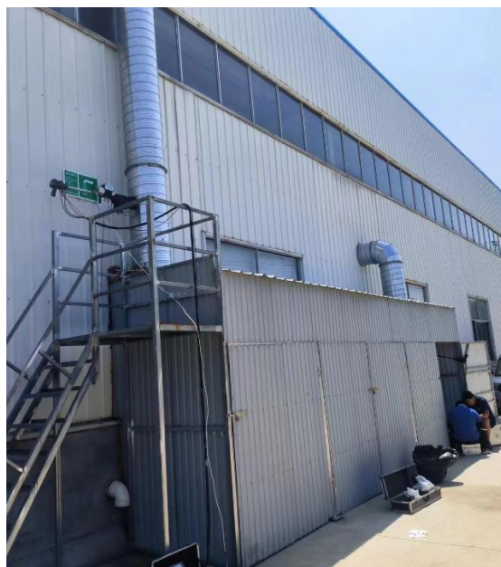
滤清器（液滤）生产线废气排放口规范化建设
