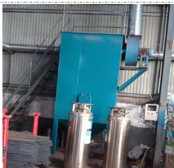
切割工序布袋除尘器
