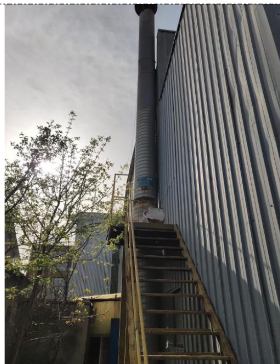
喷塑工序废气排放口规范化建设
