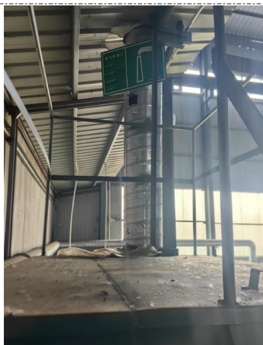
固化工序废气排放口规范化建设
