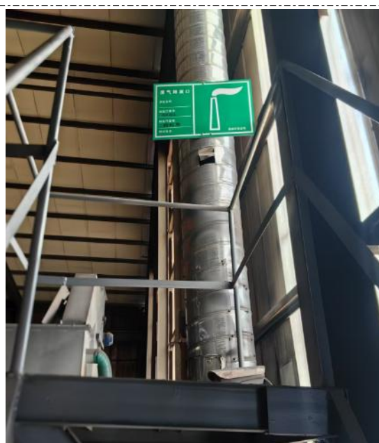
抛丸工序废气排放口规范化建设
