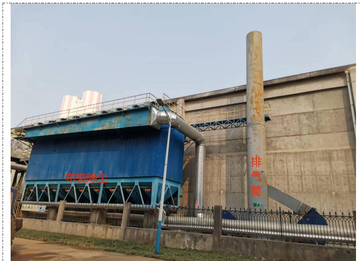
木薯卸料、投料粉工序布袋除尘器及排气筒
