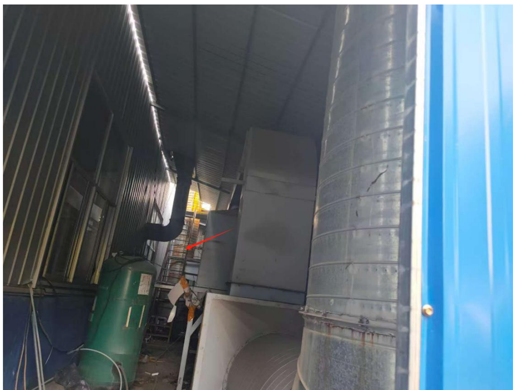
图 4-6 废气排放口采样监测平台及标识
