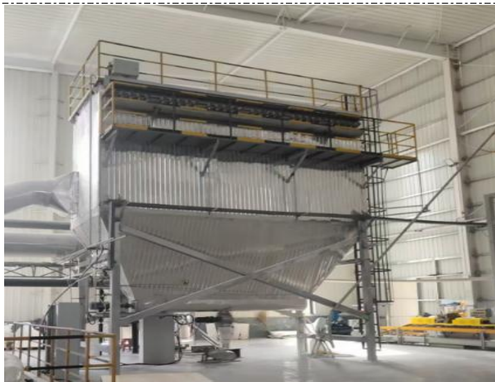
水滑石车间脉冲布袋除尘器
