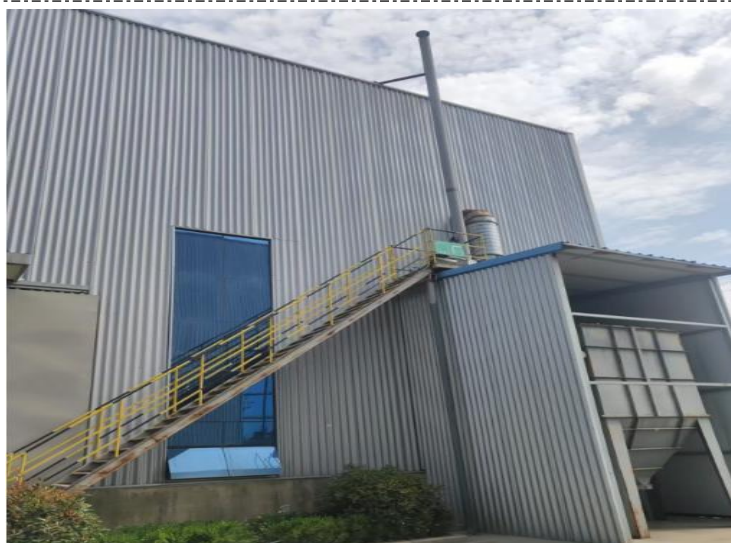
钙锌稳定剂车间脉冲布袋除尘器及废气排气筒（DA007）
