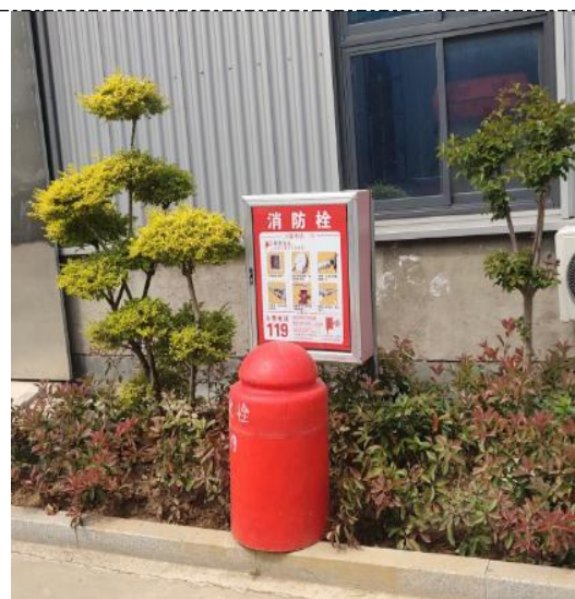
室外消防栓及消火栓
