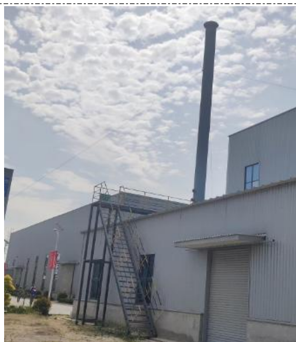
水滑石车间废气排放口规范化建设
