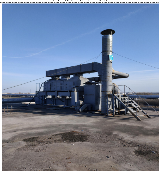
固化废气处理设施
