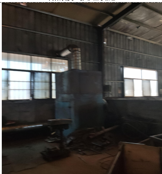
打磨废气处理设施
