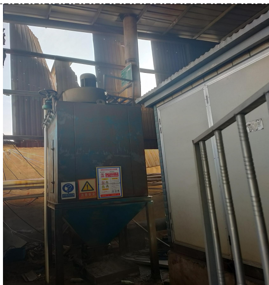
熔炼废气处理设施
